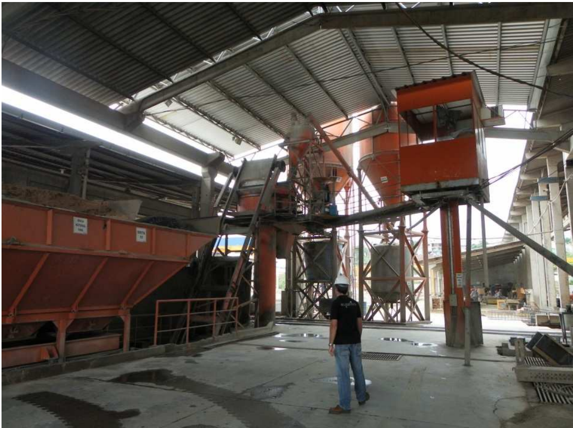
Figura 17 – Central de produção de concreto auto-adensável
