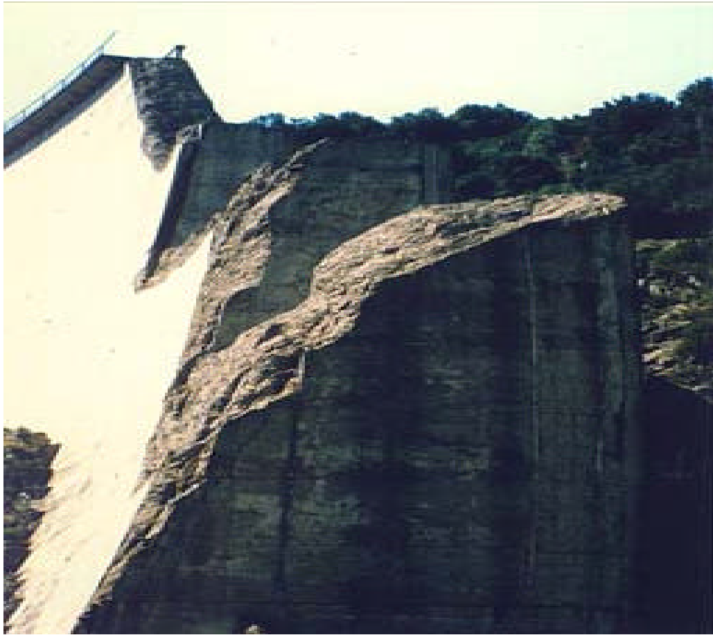
Figura 1 – Configuração atual da barragem Malpasset, França, ruída em 1959 (fonte: http://www.simscience.org/cracks/advanced/malpasset_current.html )
