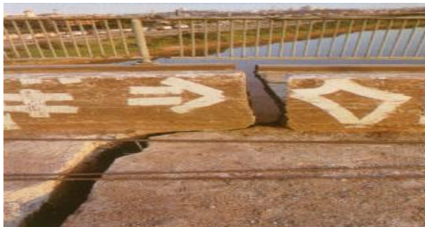
Figura 3 – Ponte dos Remédios: caso típico de falta de manutenção (fonte: COZZA(1997))
