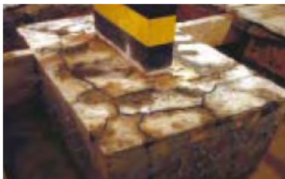
Figura 5.15 – Reação álcali-agregado atuando em bloco de fundação (Fonte: NASSAR (2006))
