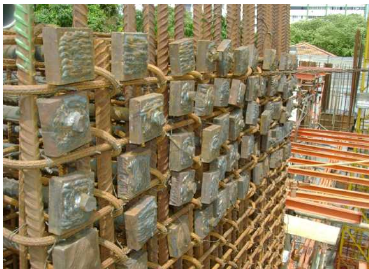
Figura 6 - Emprego de placas metálicas para a ancoragem de tirantes em viga de transição (Fonte: FILHO (2008))
