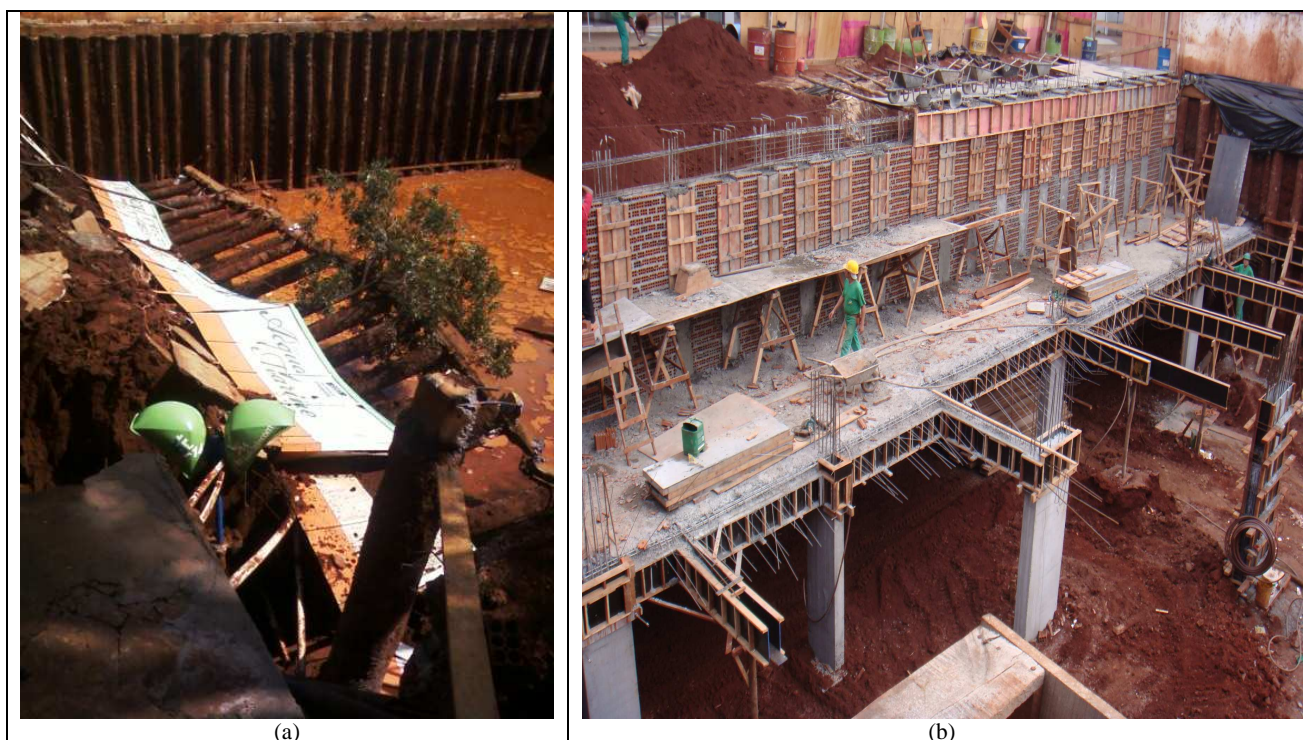
Figura 4. (a) Ruína de cortina de estacas no subsolo de edifício em construção e (b) Cortina reconstruída para liberação de tráfego em rua adjacente
