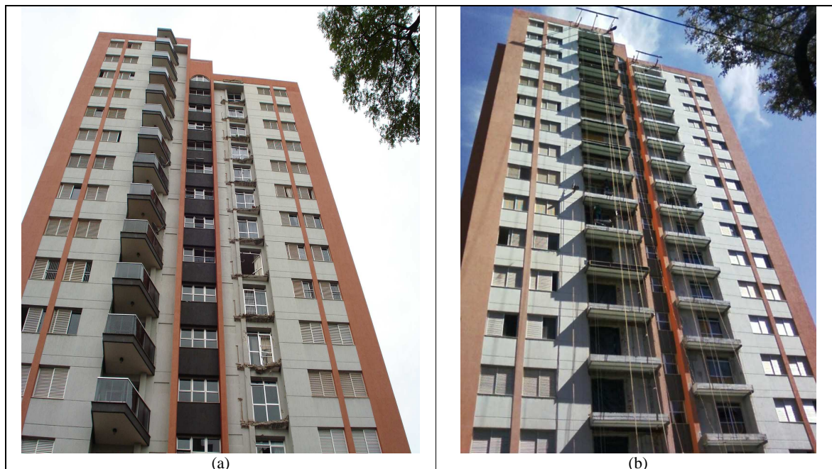
Figura 3. (a) Ruína em cadeia das sacadas situadas na lateral direita do edifício e (b) Sacadas reconstruídas para revitalização da fachada ainda em execução em Julho de 2009
