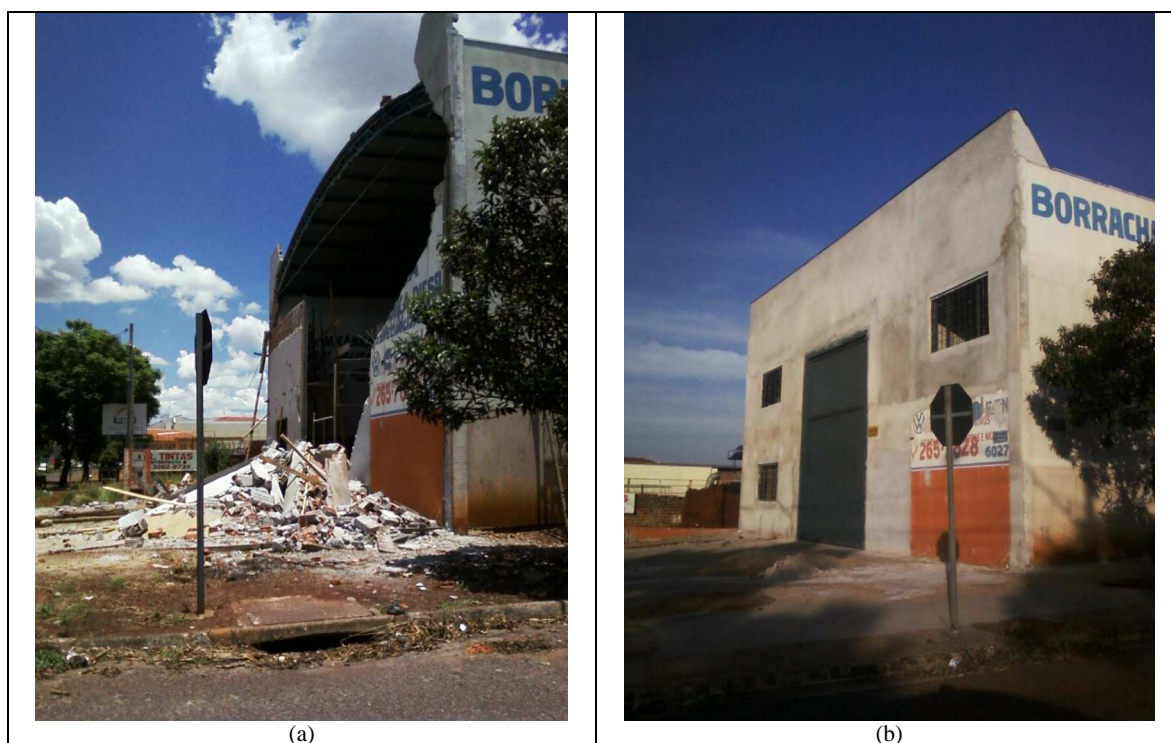
Figura 2. (a) Ruína da marquise de um galpão industrial, (b) Fachada reconstruída sem a marquise que deu origem ao colapso
